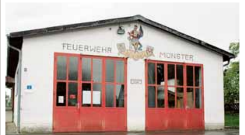
Als Sanierungsfall erweist sich das Feuerwehrhaus in Münster. Die Fassade bröckelt, die Tore rosten und das Dach hat seine Zeit auch schon hinter sich. Nun hoffen die Feuerwehrler auf eine Sanierung. Foto: Christian Kruppe
