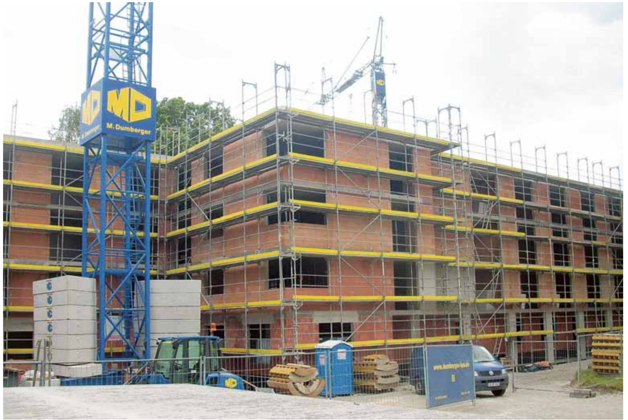
Ein imposanter Rohbau wurde zwischen dem Krankenhaus und der Gaststätte Einkehr zum Hasen erstellt.
